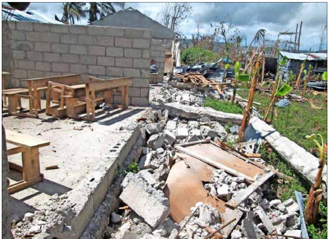
Een door Finado gefinancierde school, verwoest door de orkaan Matthew. © Finado vzw
